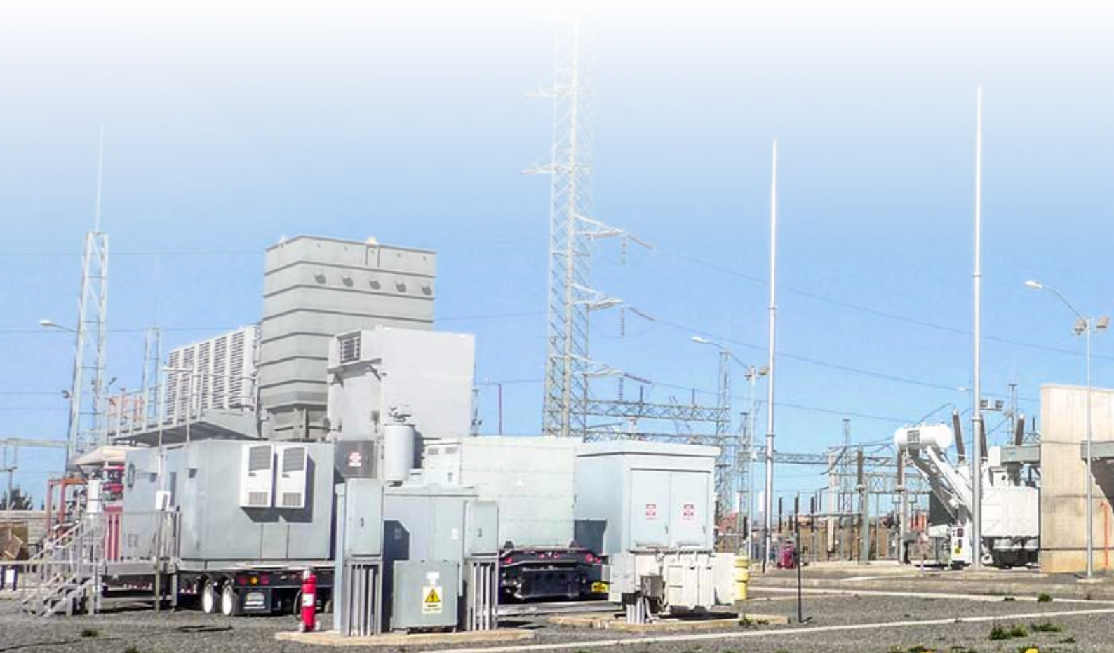
CENTRAL TERMOELÉCTRICA - EL ALTO
