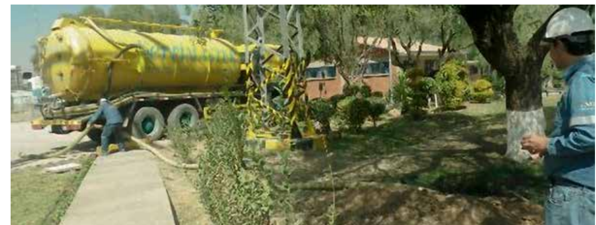
▲ Mantenimiento y limpieza de pozos sépticos para disposición final de residuos por Servicios Especializados – Central Termoeléctrica Valle Hermoso
