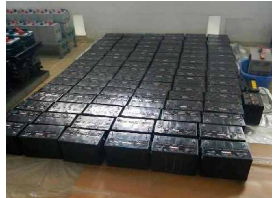
▲ Baterías de sala de control local CAR 01 – Central Termoeléctrica Carrasco.
