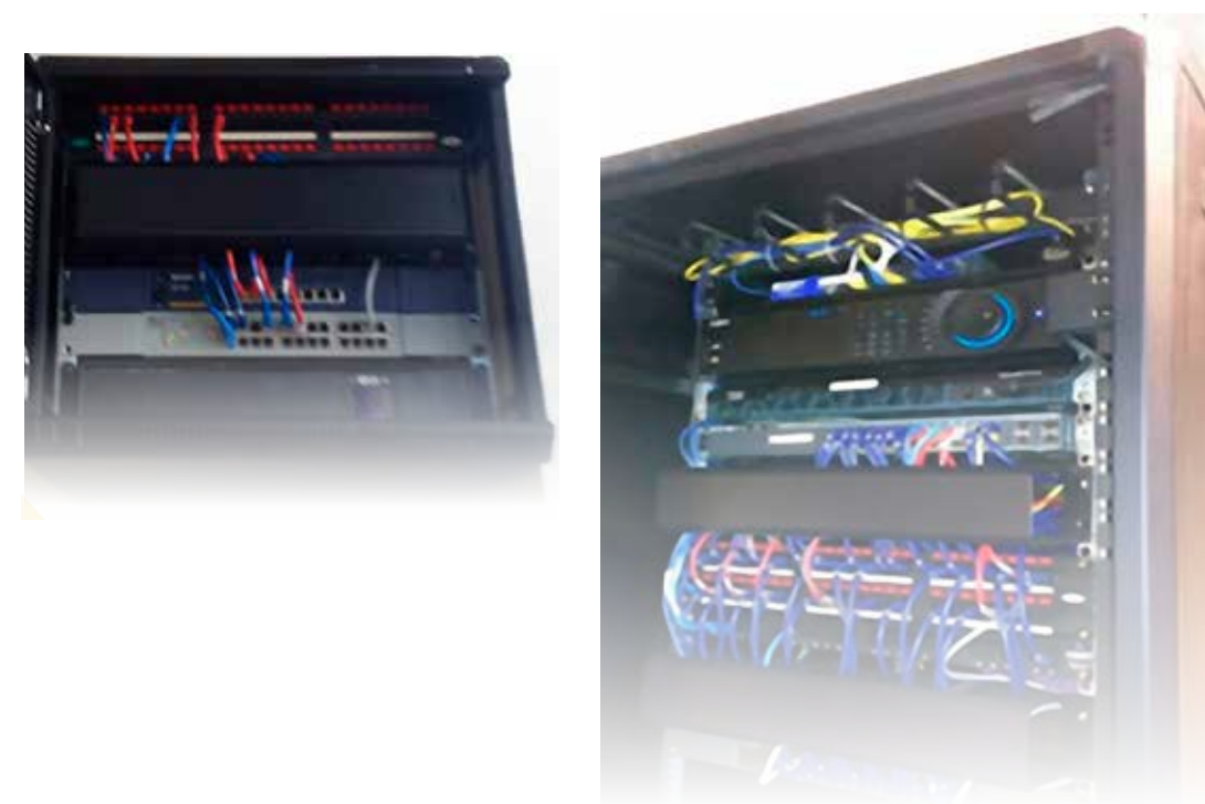
Rack de comunicación Central El Alto
