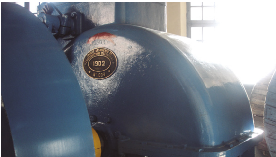
Turbina de la Central Hidroeléctrica Landara
