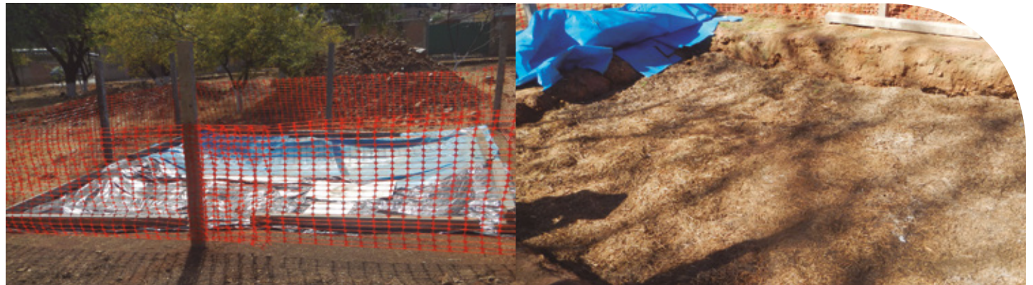
Fosas de Compostaje - Central Termoeléctrica Valle Hermoso
