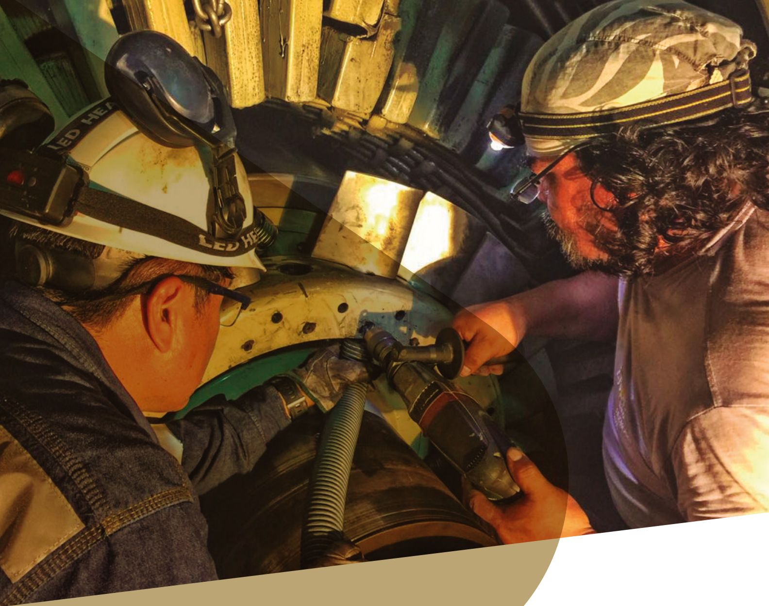
MANTENIMIENTO DE GENERADORES - CAR 02
