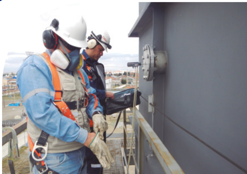
Monitoreo y medición de Gases de Escape a Unidad ALT 02 – Rolls Roys Central Termoeléctrica El Alto
