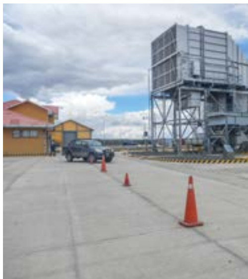
Central Termoeléctrica El Alto
