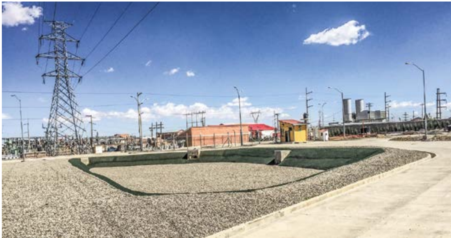
Obras de protección contra la polución ambiental – Central Termoeléctrica El Alto
