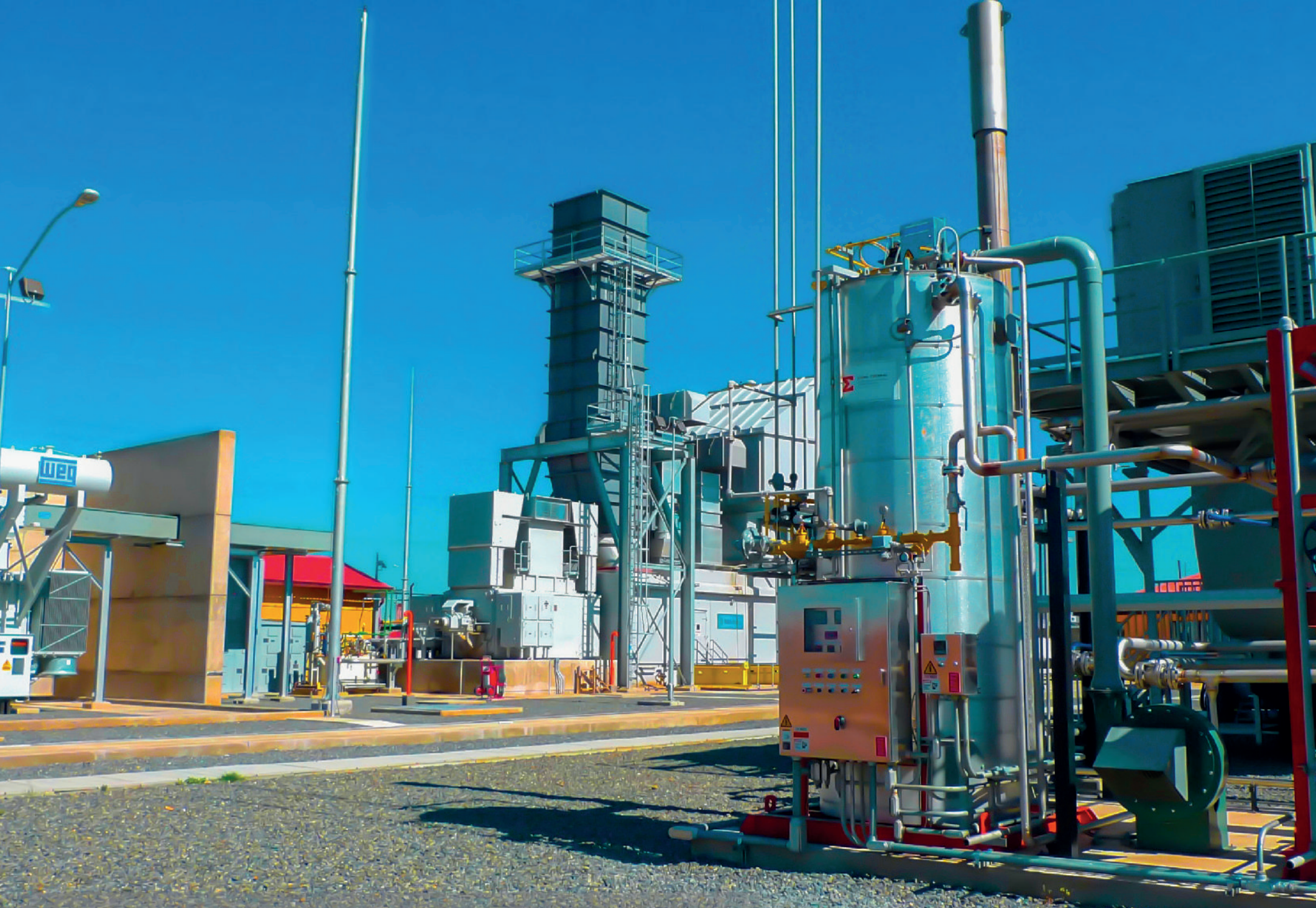
Central Termoeléctrica El Alto
